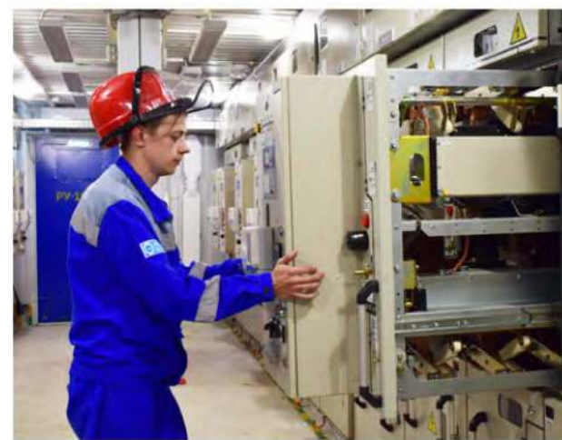
г. Камышин, ПС «Центральная»
